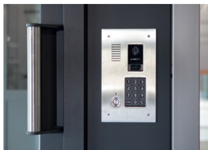
Palo tecnico con citofono
